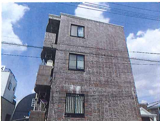
外装タイル塗布剤剥離
